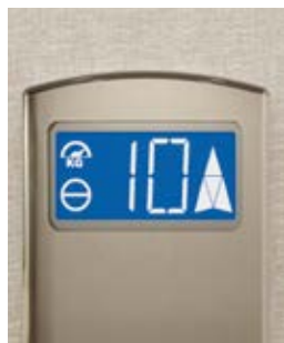
"E-Lift" - "H" - Display di cabina
